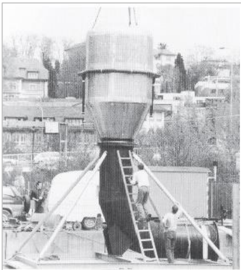
Nochmals, Ansaugkorb Rohwasser-Pumpwerk Stäfa 1990.
